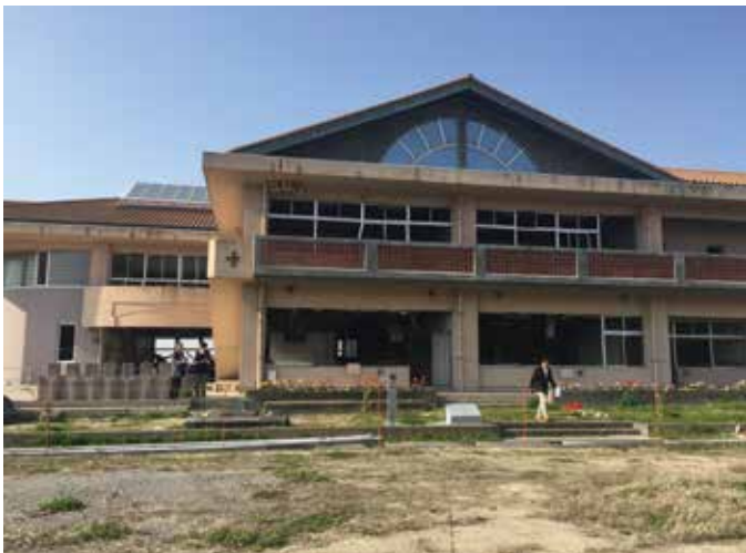
(旧中浜小学校被災校舎：宮城県山元町)
